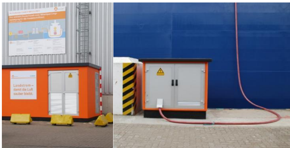
Abbildung 15: Trafo-Einheit und Steckverbindung mit Bedienelement an der Kaikante für die Landstromversorgung im Hafen Lübeck
